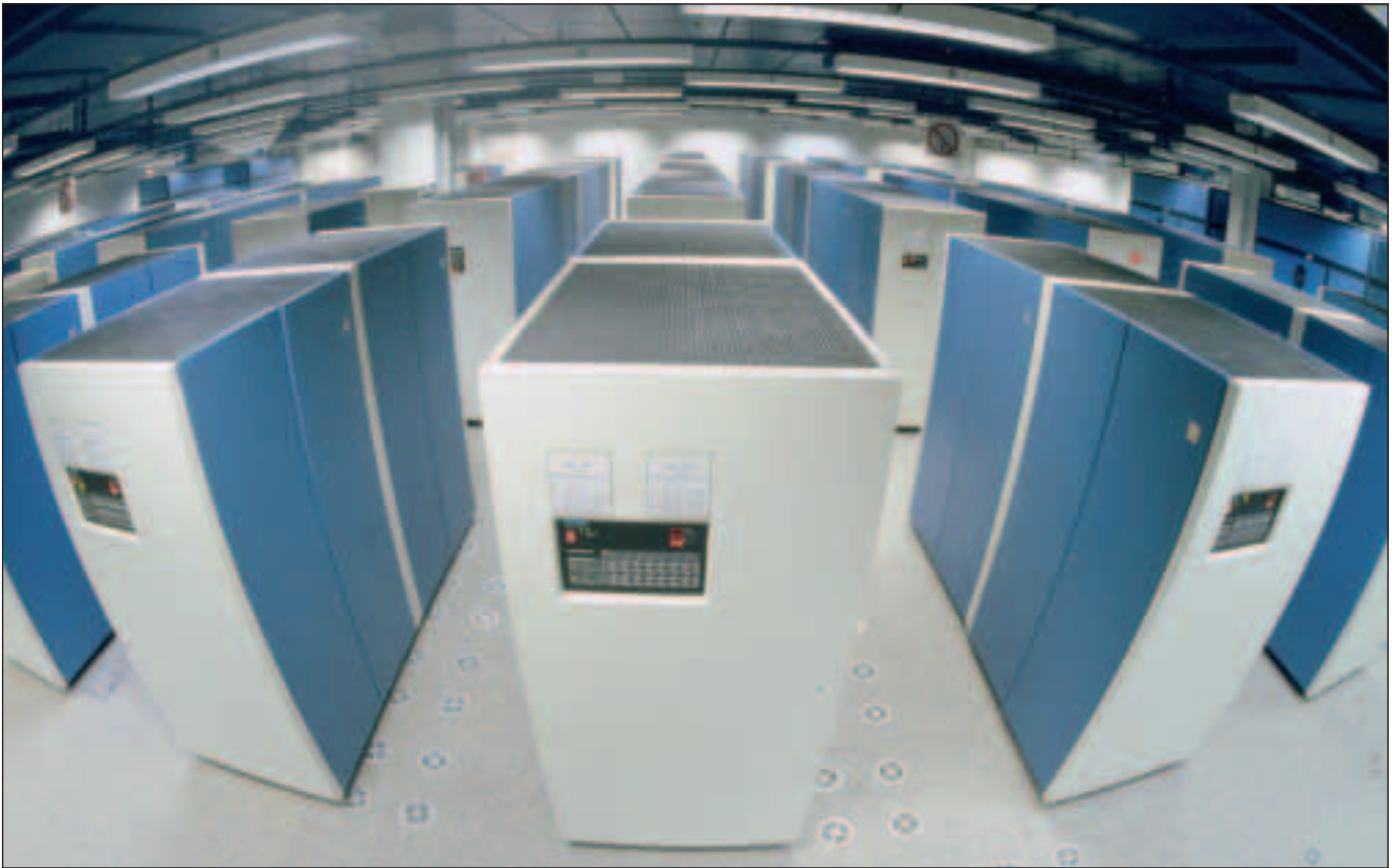
IBM 3380 Platten und 3880 Steuereinheiten füllten damals ganze Rechenzentrumshallen
